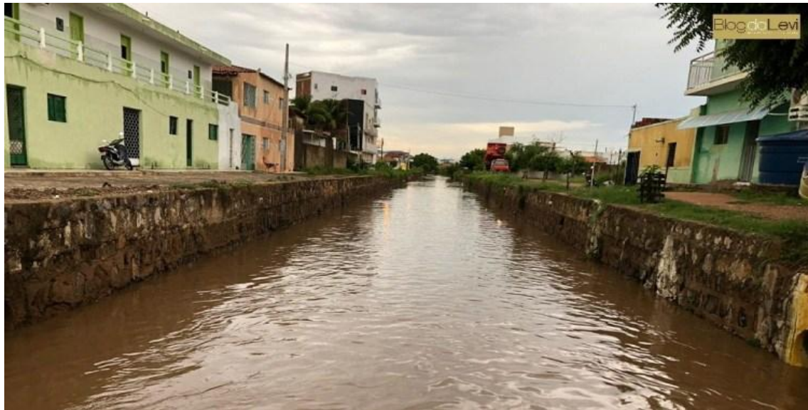
Figura 04 – Canal em Bairro do Centro da cidade de Sousa escoando águas da chuva. Fonte: Blog do Levi, 2019.
