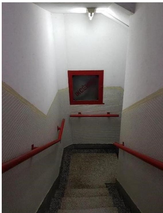
Figura 6 - Ponto de hidrante.
