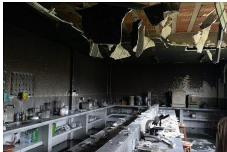
Figura 4. Incêndio na UFCG – foto 2
