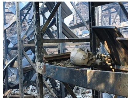
Figura 8. Incêndio na UFMG – foto 2
