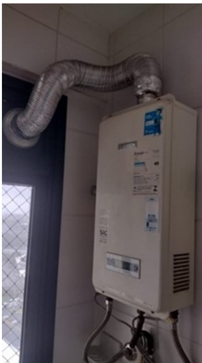
Figura 09 – Aquecedor de passagem na área de serviço (apartamento 3Q)
