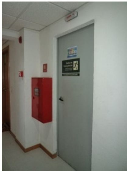
Figura 05 – Hidrante no hall do pavimento tipo
