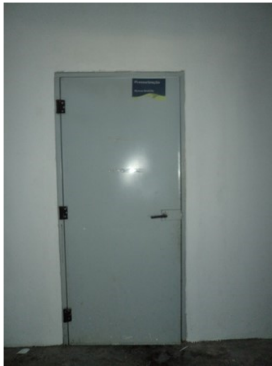
Figura 04 – Sala pressurização e escada torre 03
