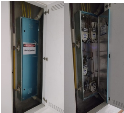
Figura 08 – Medidor de gás GN no Hall do Pavimento (04 unidades)
