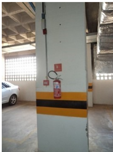
Figura 07 – Extintor na garagem 01
