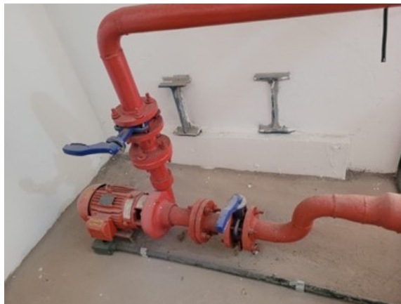
Figura 06 – Bomba de sprinklers no barrilete da torre 02
