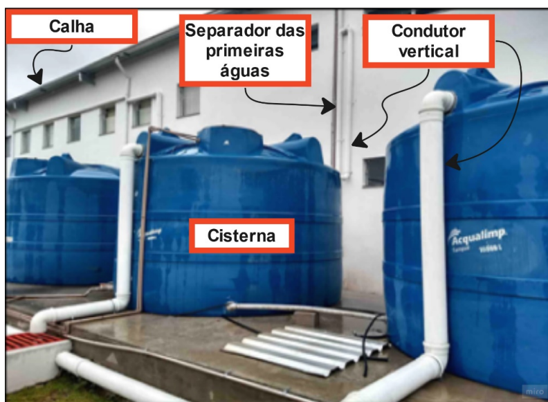
Figura 7 –Reservatório para aproveitamento de água de chuva.
