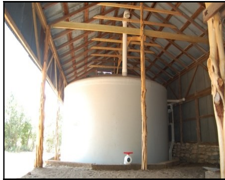
Figura 2 - Acumulação de água de chuva para combate a incêndios - Texas EUA.
