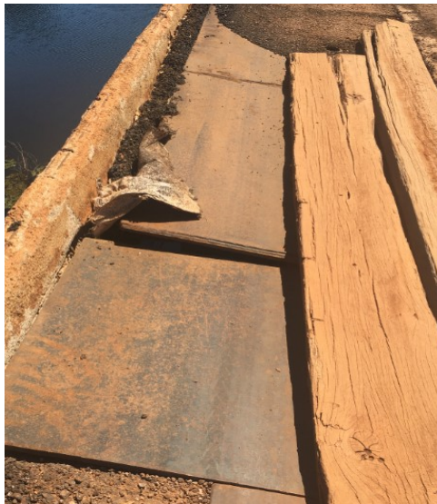
Figura 6 – Improvisos na substituição dos tabuleiros danificados.
