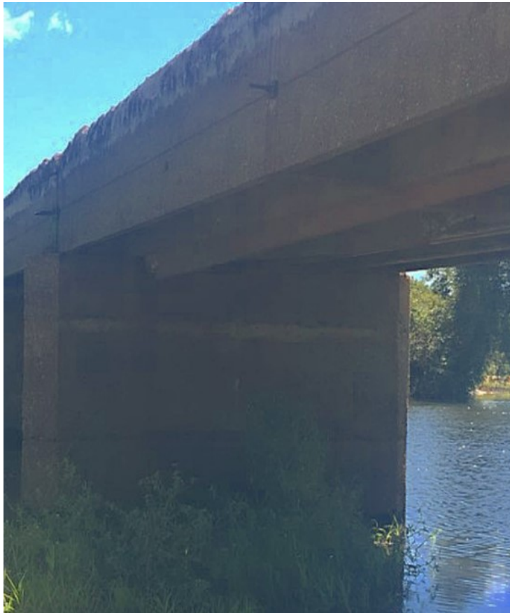
Figura 7 – Vigas deslocadas e armaduras expostas.
