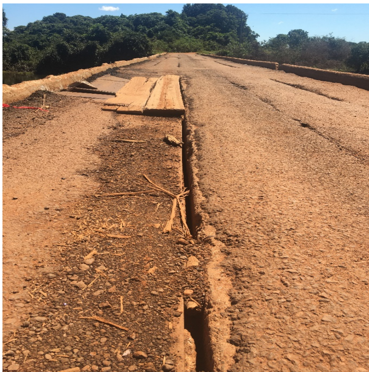
Figura 4 – Ponte danificada sobre o Rio Urubu.
