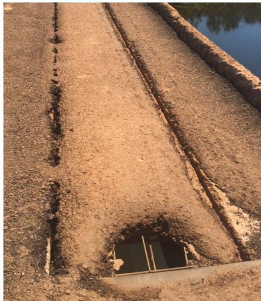
Figura 5 – Tabuleiros danificados e armaduras expostas
