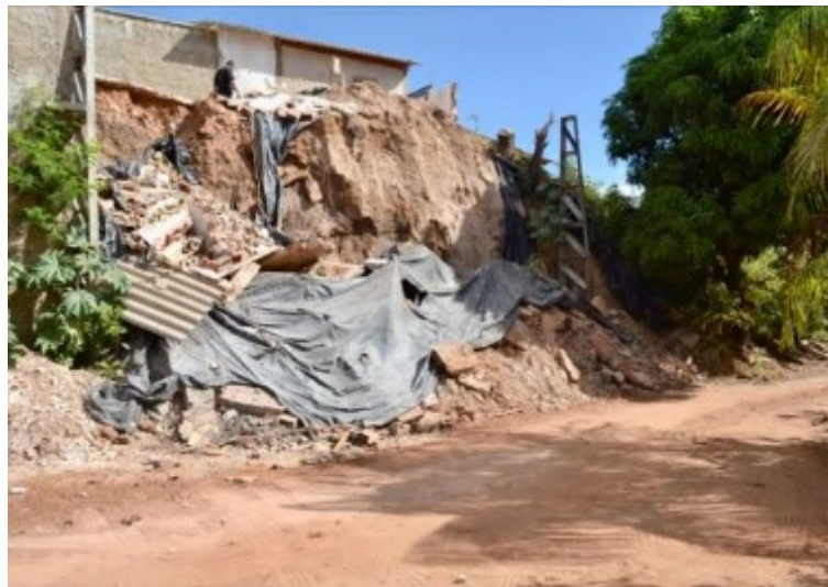
Figura 3 – Muro de contenção colapsado
