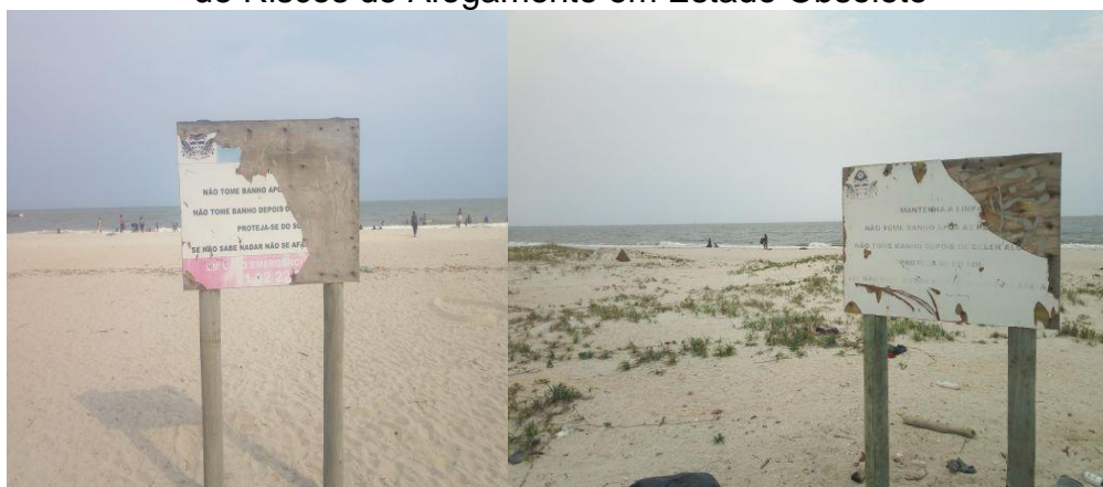
Figura 13 - Sinalização Fixa na Praia da Costa do Sol: Placas de Advertência de Riscos de Afogamento em Estado Obsoleto
