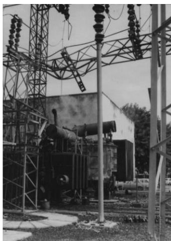
Figura 4. Colapso de barramento superior devido a um incêndio.
