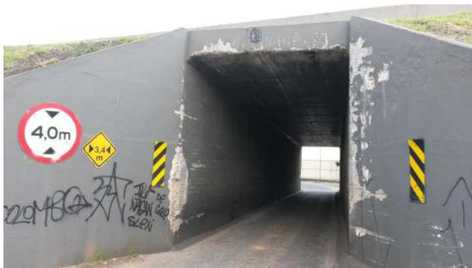
Figura 10 – Município de Colombo, trincheira da rua Dezenove de Novembro com a BR 476 Fonte: Fernandes (2015)
